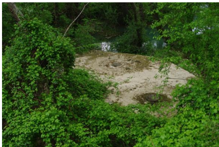
Slika 3.2.4. Izvedeno stanje zdenaca i platforme crpne stanice na izvoru Sv. Anton
