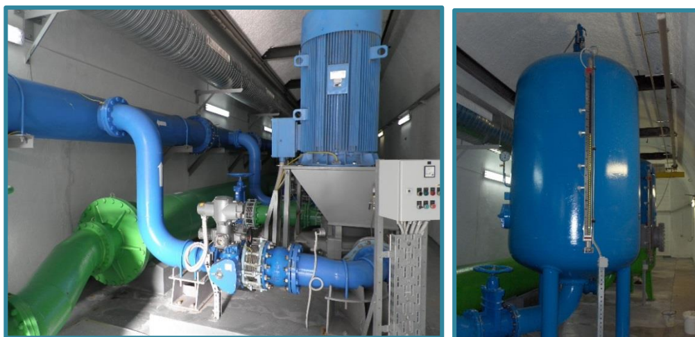
Slika 80: Crpna stanica Ruda na ulazu u tunel
