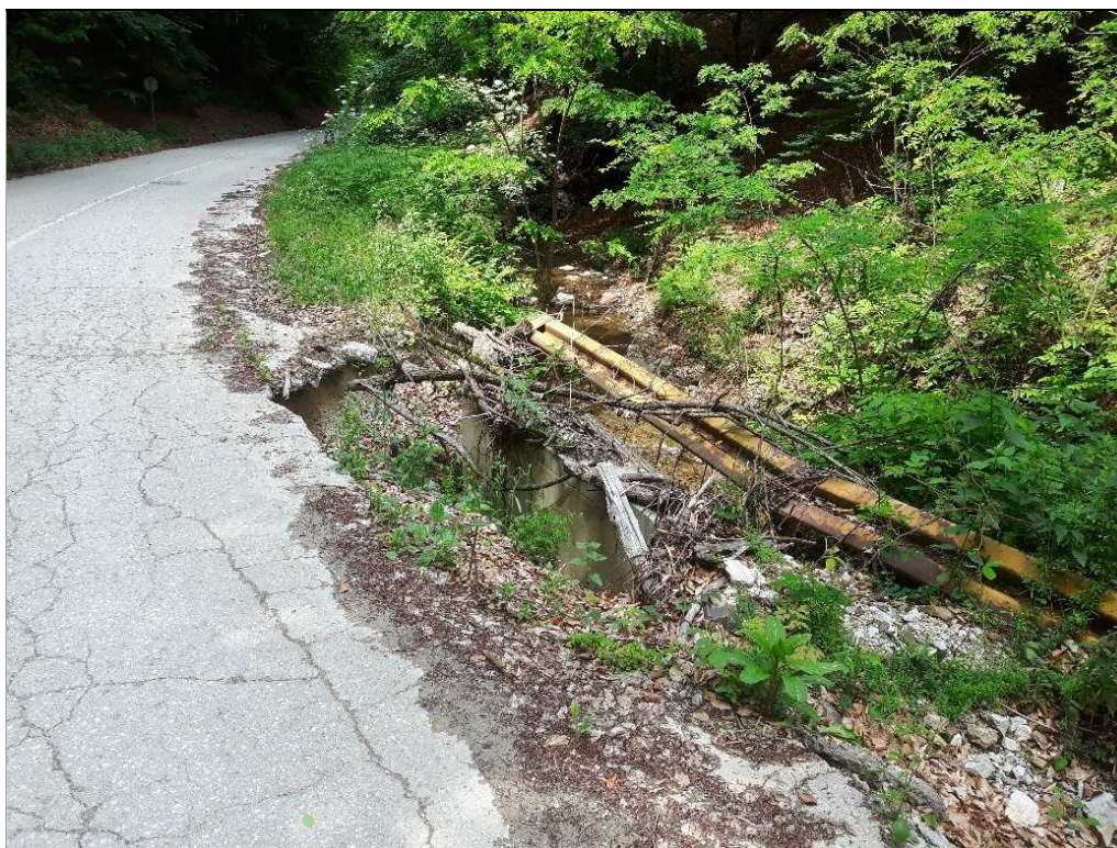
Slika 6-16 Urušenje asfalta kao posljedica buičnih vodotoka
