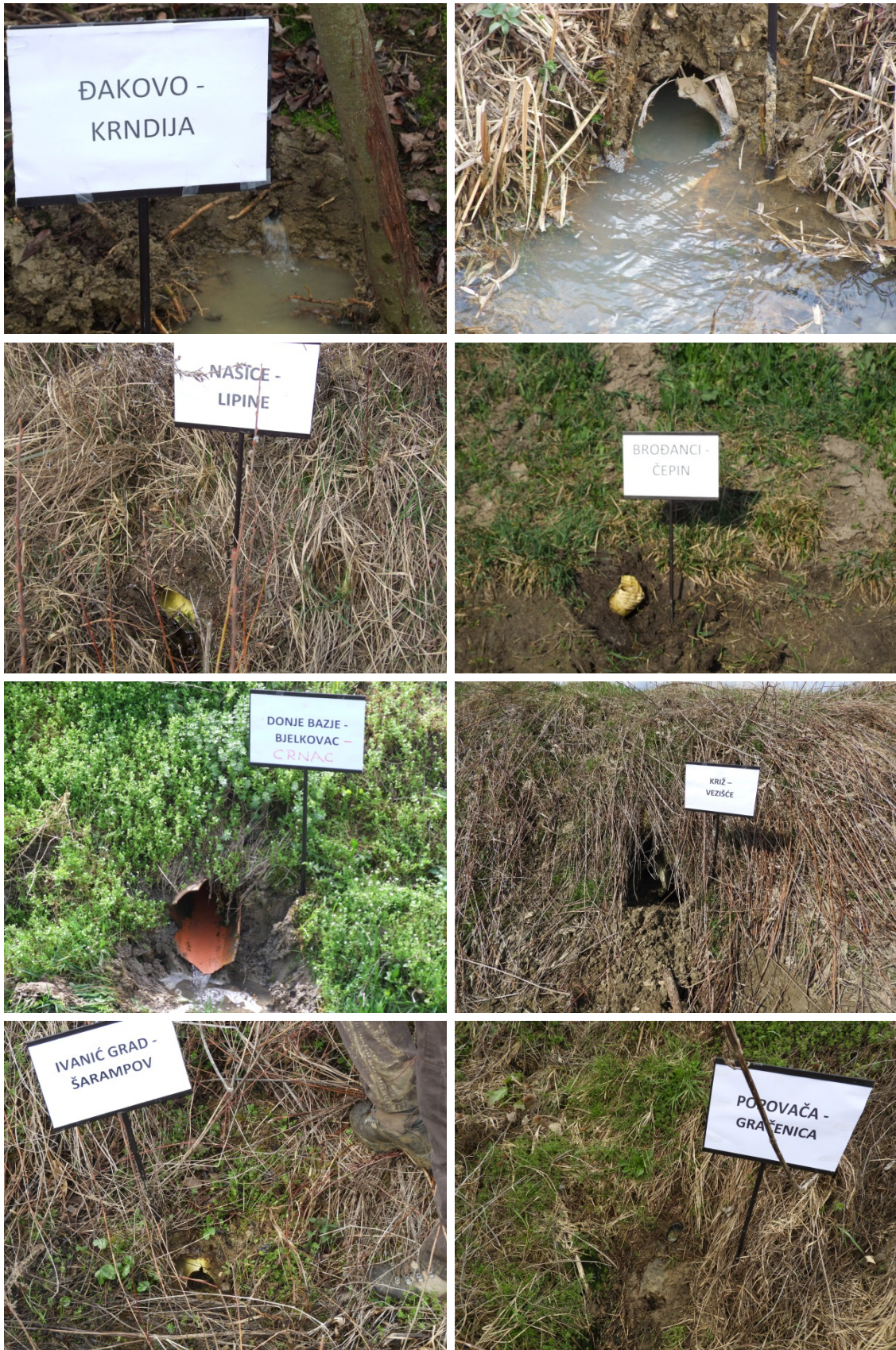
Slika 8. Fotografski prikazi kao primjeri lošeg stanja hidromelioracijskog sustava podzemne odvodnje-cijevne drenaže (2017-2019)
