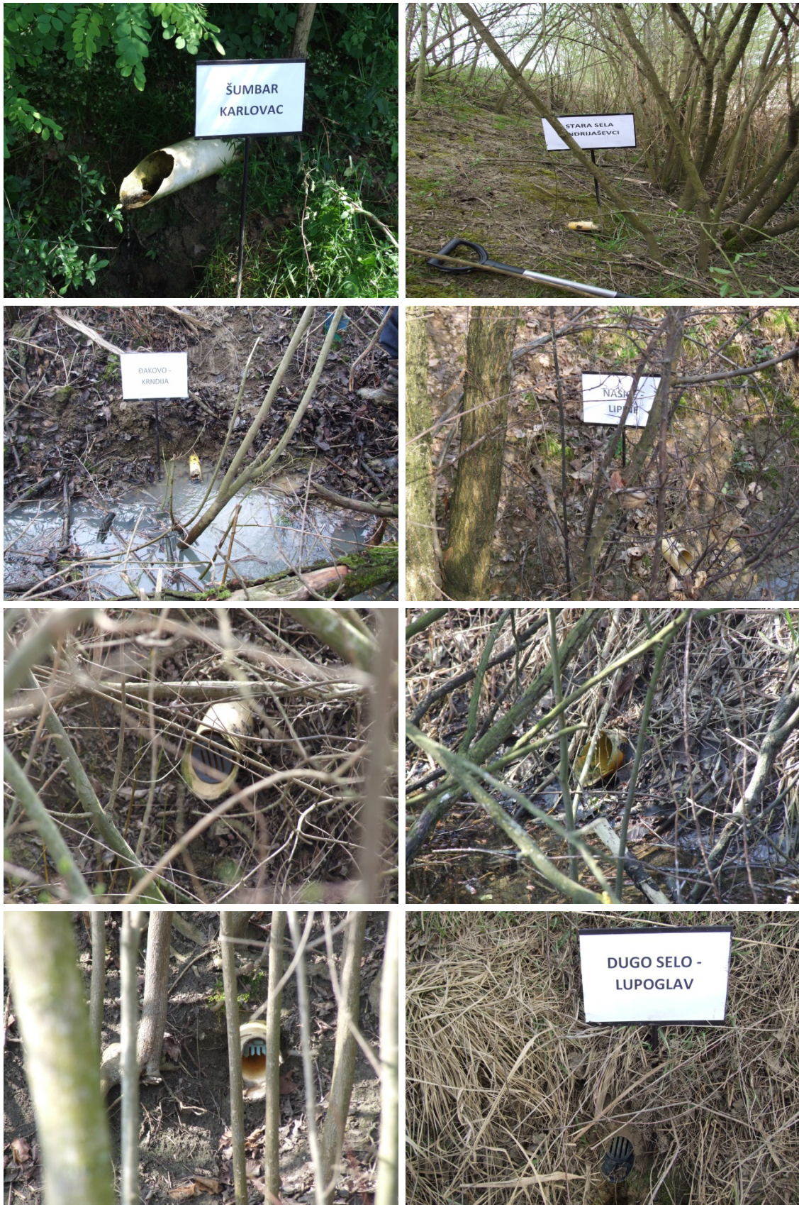
Slika 10. Fotografski prikazi kao primjeri prvog oblika devastacije - zapuštenosti hidromelioracijskog sustava podzemne odvodnje-cijevne drenaže (2017-2019)
