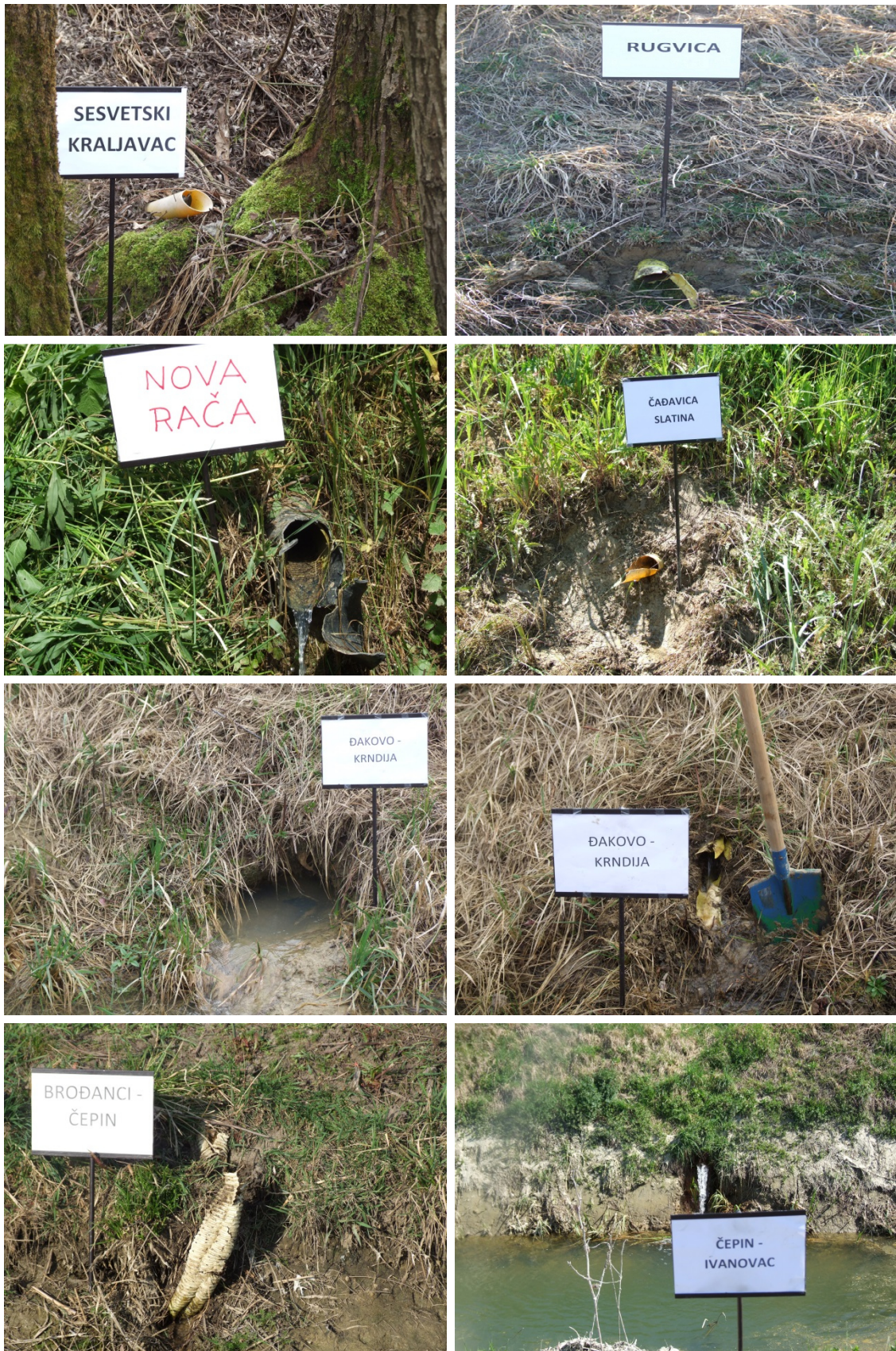
Slika 11. Fotografski prikazi kao primjeri drugog oblika devastacije hidromelioracijskog sustava podzemne odvodnje-cijevne drenaže tijekom obnove kanala III./IV. reda (snimljeno 2017-2019)
