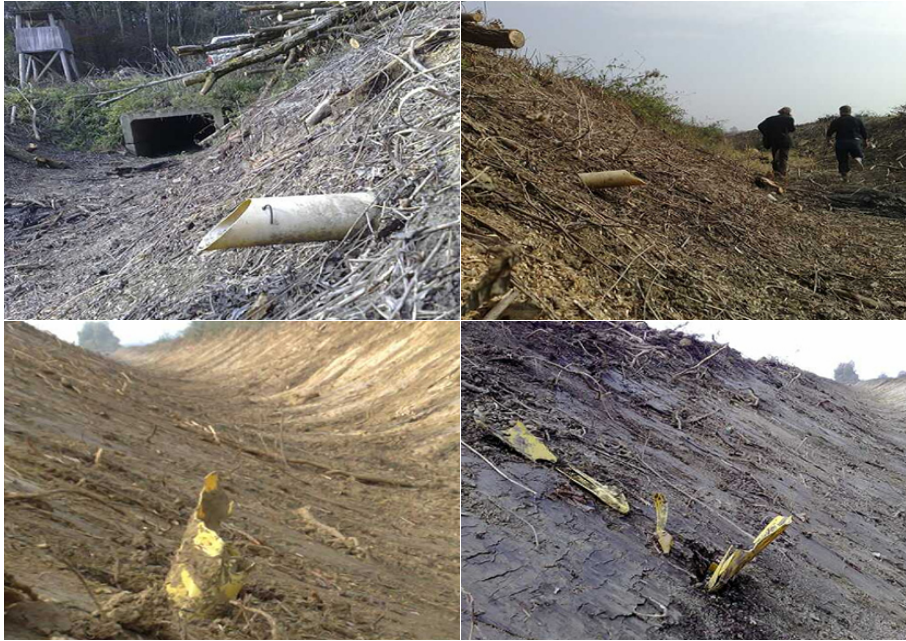
Slika 12. Prikaz oštećenja i devastacije sustava cijevne drenaže u postupku obnove melioracijskih kanala III./IV. reda (Zagrebačka županija, Božjakovina)
