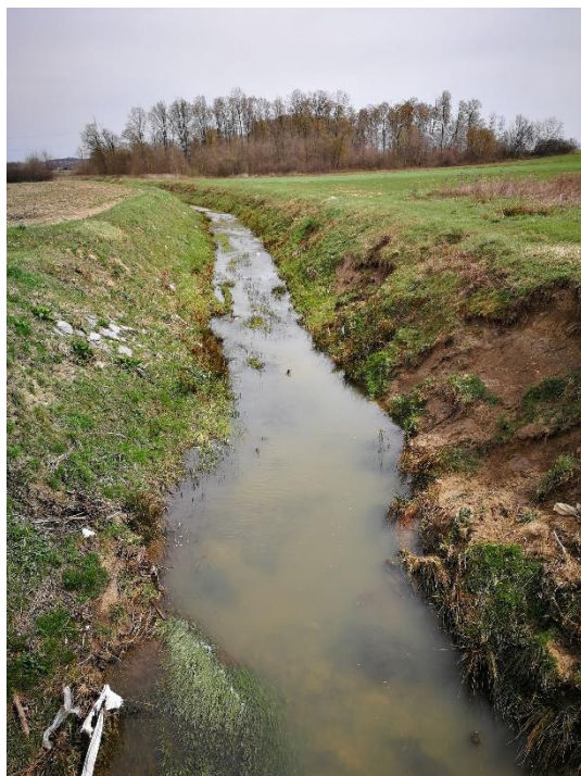
Slika 110.1c: Kašina – erozijski procesi
