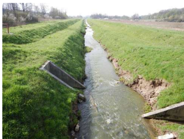
Slika 1d: Garešnica, uzvodno od Garešnice – nizvodno od dionice
