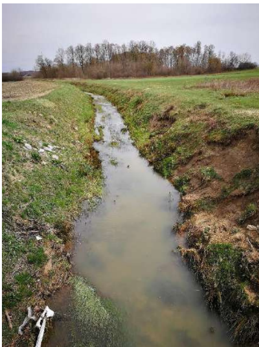
Slika 1c: Kašina – erozijski procesi
