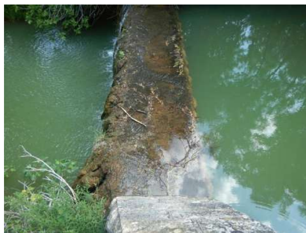
Slika 1b: Preljevna brana na odsječku visine 3 metra
