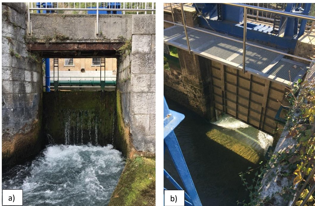
Slika 3.5. Glavna zapornica a) procjeđivanje kroz zatvorenu glavnu zapornicu prije njezine zamjene, b) nova zapornica nakon zamjene stare
