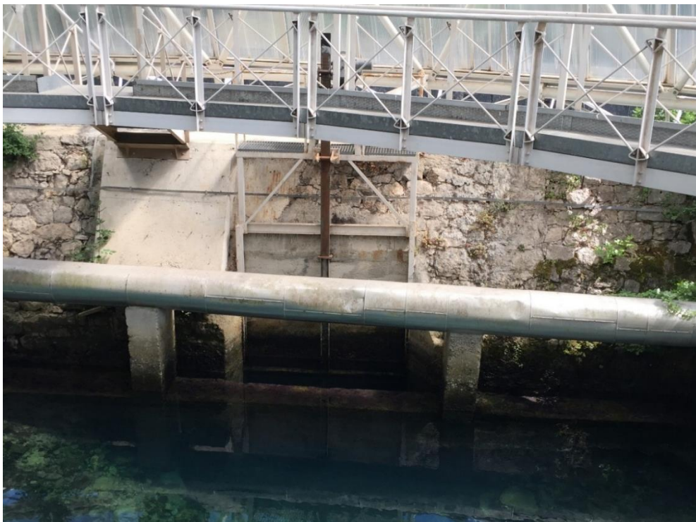
Slika 2.5. Pomoćna (servisna) zapornica u unutarnjem crpnom bazenu ispod kupole
