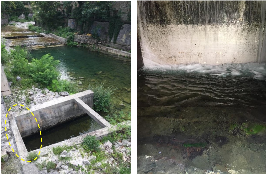
Slika 3.4. Procjeđivanje voda kroz zatvorenu pomoćnu (servisnu) zapornicu (dne 4.7.2017.)
