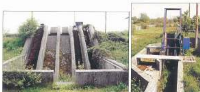
Slika 5.30: Rešetka i crpna stanica uređaja za pročišćavanje u Topuskom.
