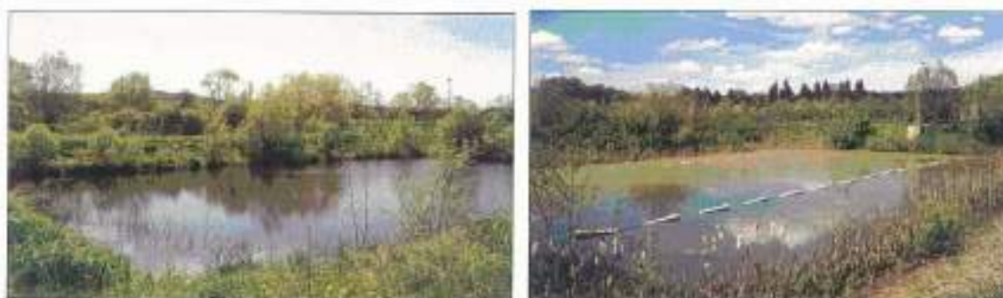
Slika 5.31: Taložna laguna i aeracijska laguna za pročišćavanje u Topuskom.
