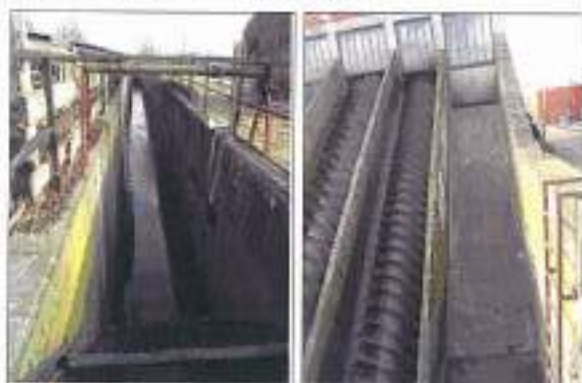
Slika 5.29: Rešetka i crpna stanica uređaja za pročišćavanje u Kutini.
