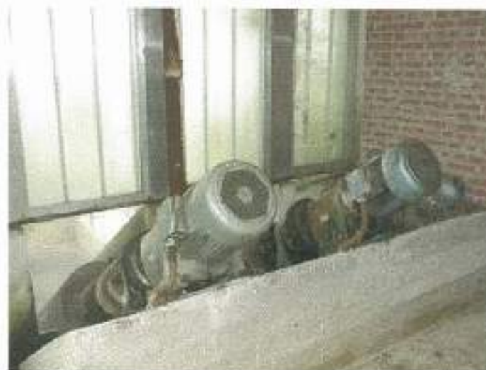
Slika 13: Elektromotori pužnih crpki
