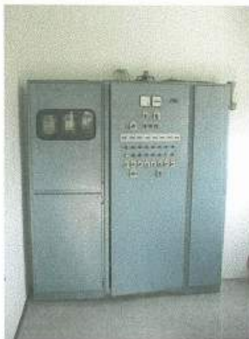
Slika 11: Ormar rasklopa i automatike u komandnoj zgradi
