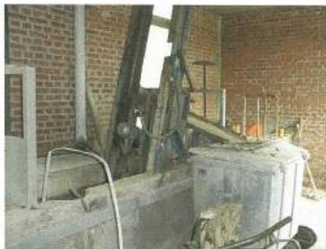
Slika 15: Neispravna automatska rešetka
