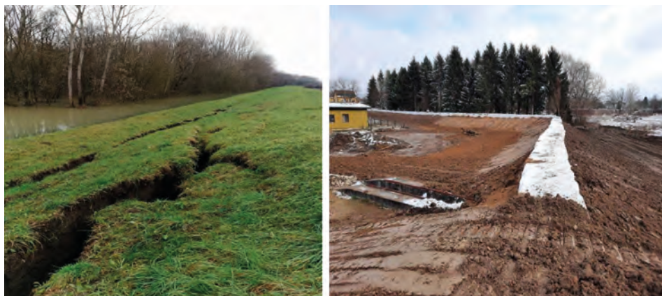
Slika 13. Galdovo - oštećenja i obnova nasipa
