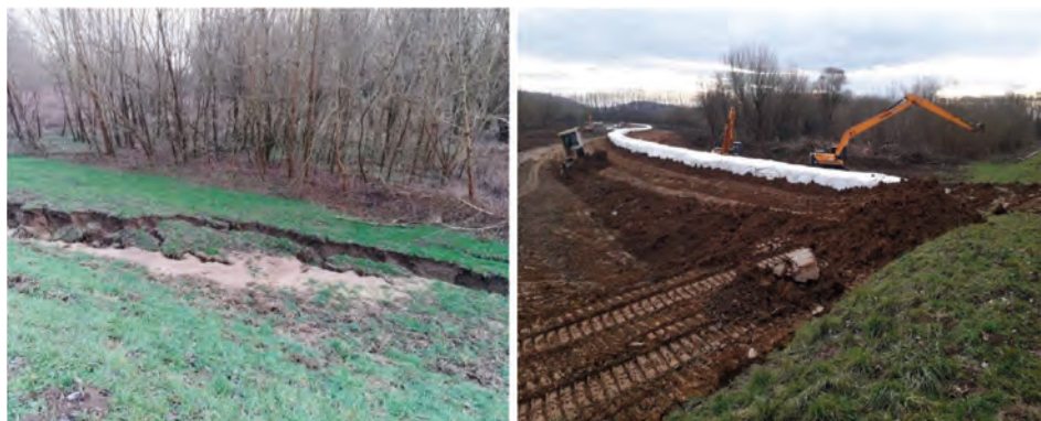
Slika 15. Krnjica - oštećenja nasipa i radovi na uspostavi druge linije obrane od poplava
