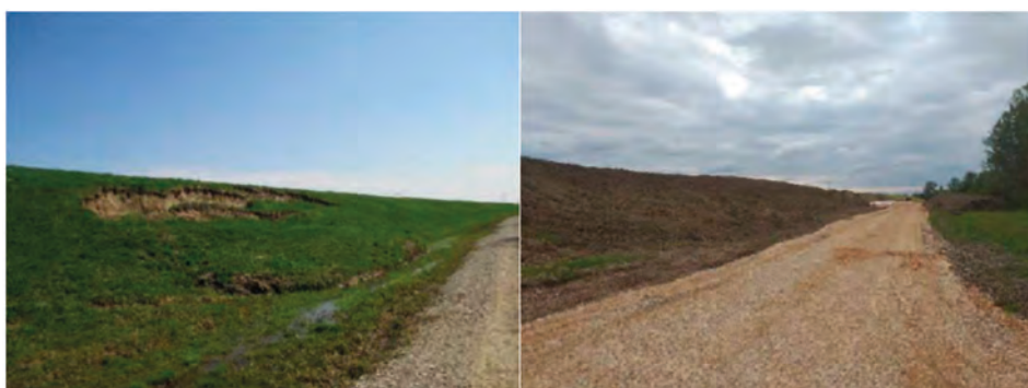
Slika 6. Branjeno područje 13 - lokacija: OK Odra - desni nasip prije i nakon sanacije
