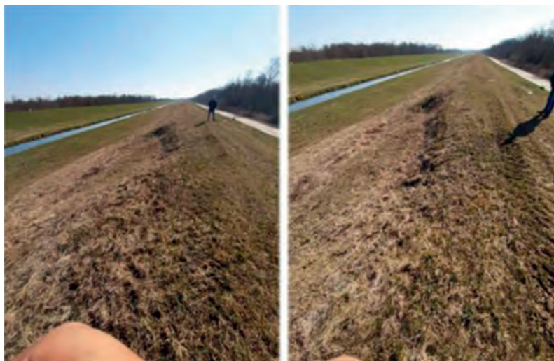
Slika 4. Branjeno područje 8 - lokacija: desni nasip spojnog kanal Z-L-G-Č - oštećenja (slijeganje tla)
